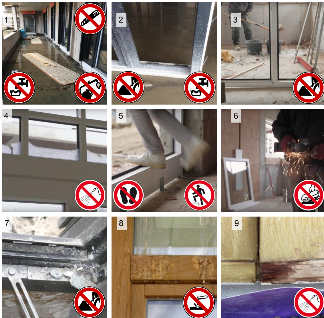
Bild 5 Gefahren im Baustellenalltag mit hohem Schadenrisiko (Bildreihe oben, Mitte) und Beispiele von Totalschäden durch außergewöhnliche Belastungen in der „nassen“ Bauphase (Bildreihe unten) (Quellen: Bilder 1 und 2: Fa. Hilzinger GmbH, Bilder 3 bis 6: Fa. Döpfner Betriebs GmbH & Co. KG, Bilder 7 bis 9: ift Rosenheim GmbH)
